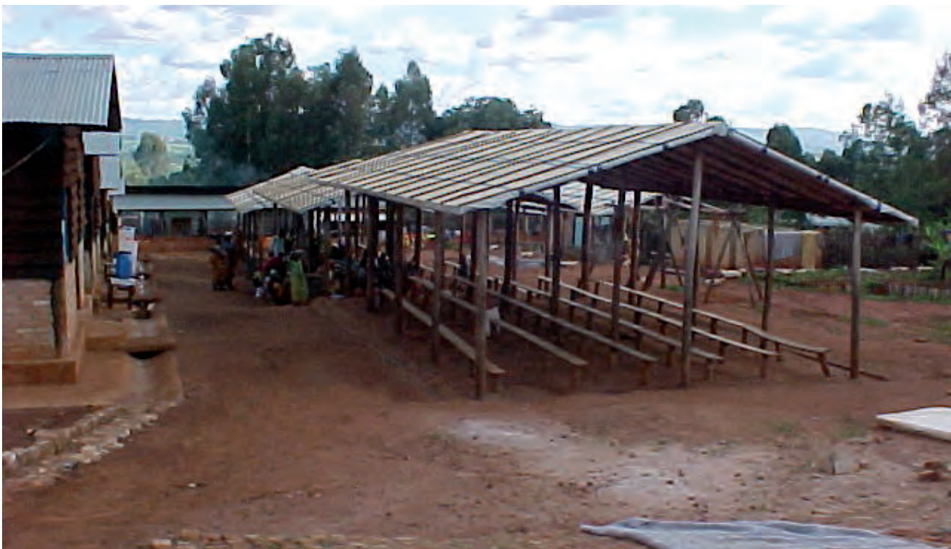
WAITING AREA COVERED WITH PLASTIC SHEETING / ZONE D'ATTENTE EN BÂCHE PLASTIQUE MSF, BURUNDI
